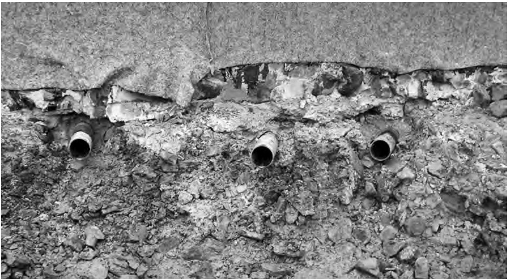
Obr. 3.20 Vystrojené horizontální odvodňovací vrty.
