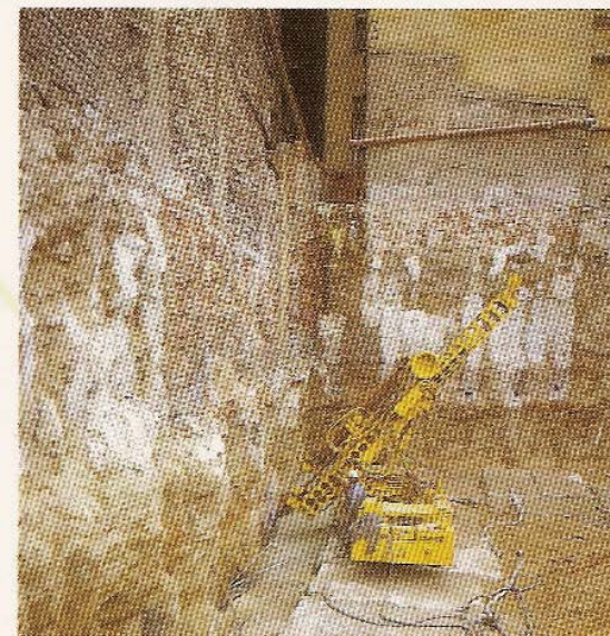
Stavební jáma pro hotel Penta v Praze - podchycení obvodových zdí sousedních objektů
