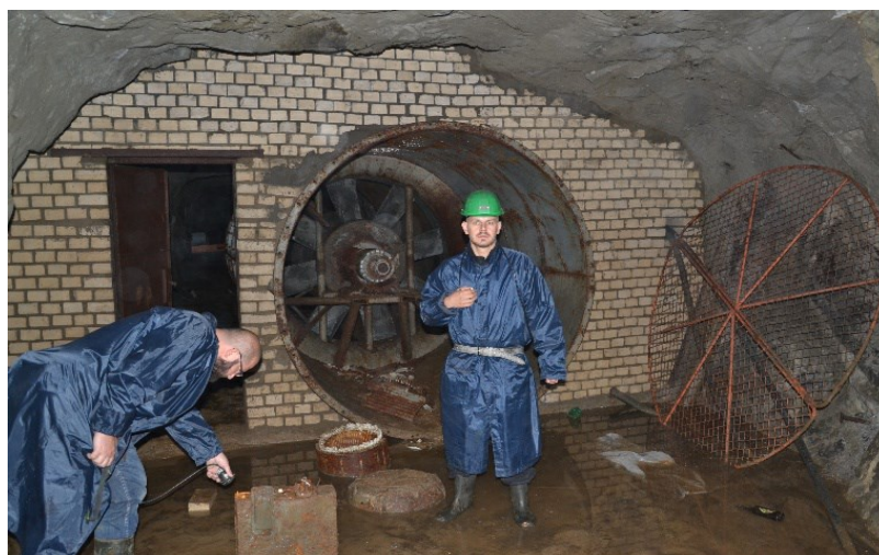
Obrázek 5 Ventilátorovna spolu s hlavním důlním ventilátorem, skutečný stav, 2017
